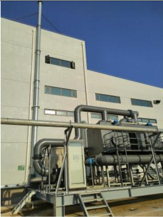
2#两级活性炭吸附+蒸汽脱附+冷凝回收废气处理设施（灌装、室内调和废气）
