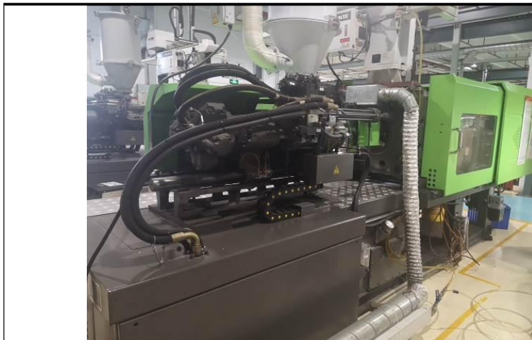
注塑废气收集设施现场照
