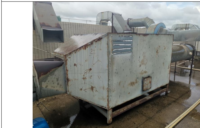
废气处理设施（单级活性炭吸附装置）现场照
