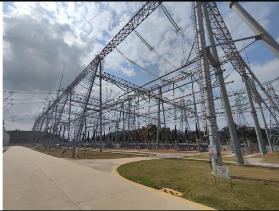
500kV 配电装置区
