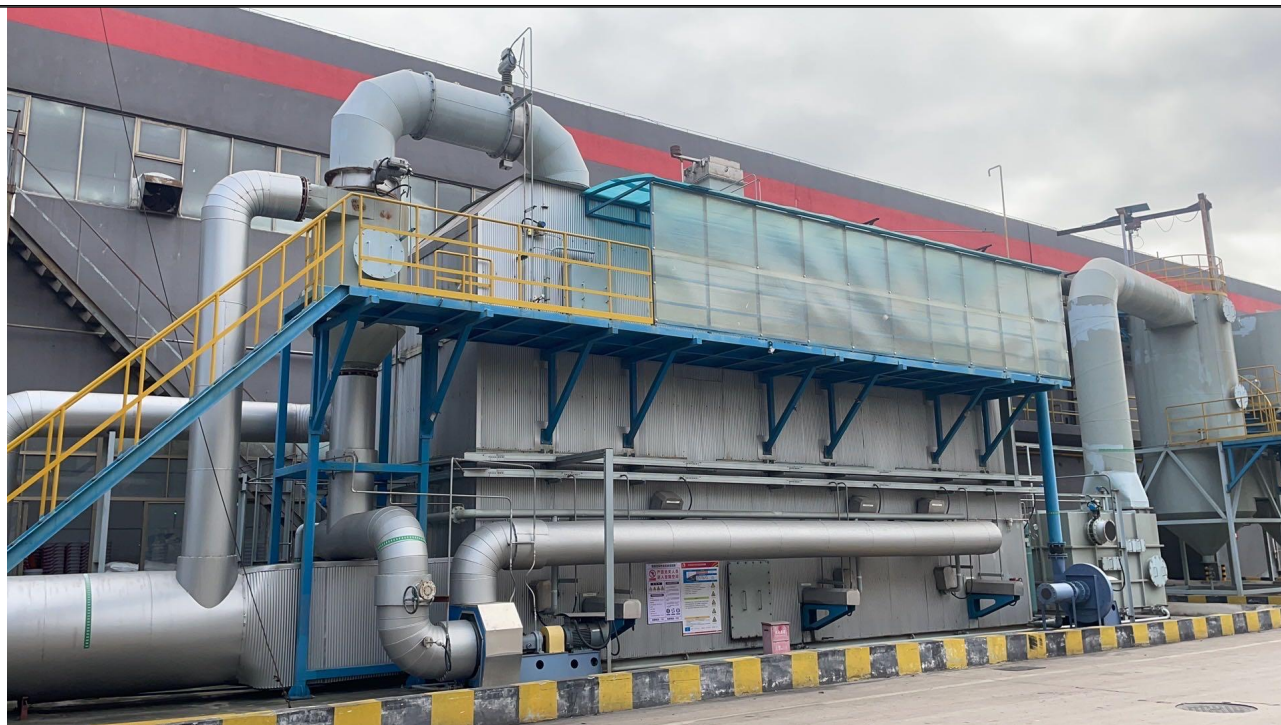
除尘除油预处理+RTO 蓄热式废气焚烧
